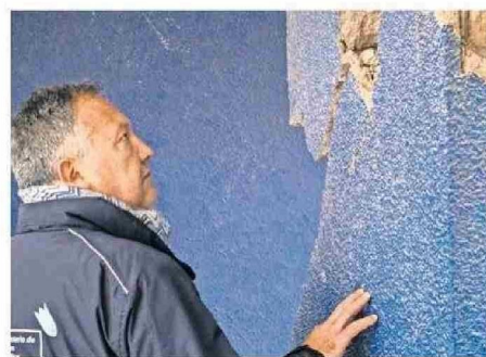
UNA DE LAS GRIETAS QUE ESTÁ CERCA DEL ASCENSOR DEL RECINTO
