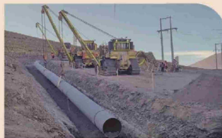
PIPELINES DE ACERO CARBONO Y HDPE Foto: Compañía Minera Doña Inés de Collahuasi
