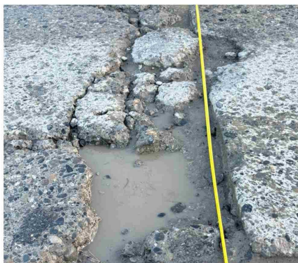
Los hoyos en el pavimento ocupan toda la calzada.
