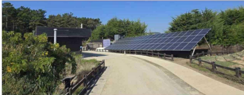
Los 60 paneles solares aportan parte de la energía que requiere el sistema.
