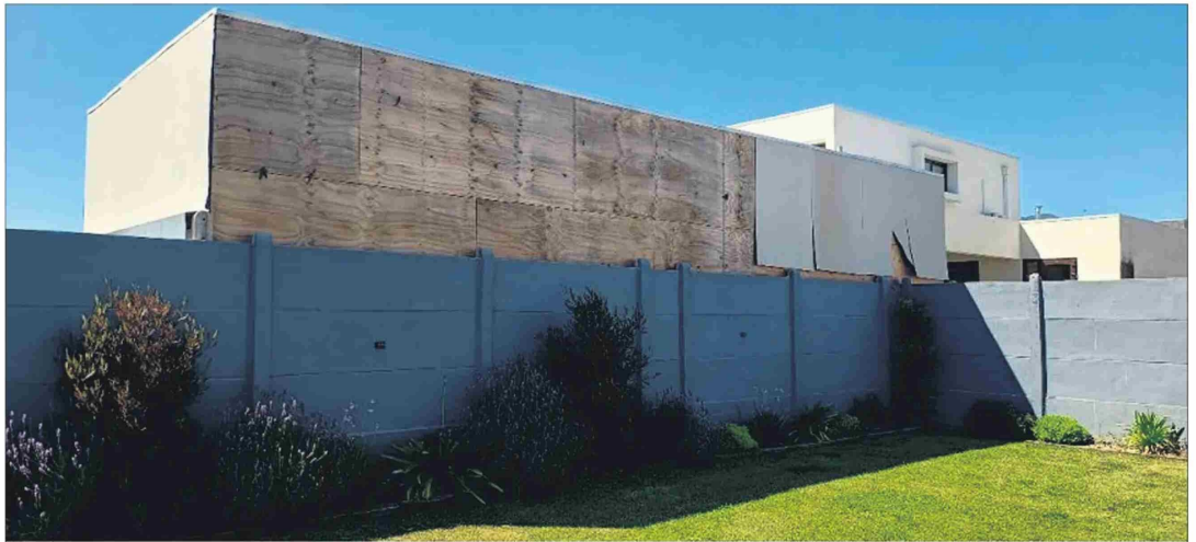
El quincho está pegado al muro medianero, lo que está prohibido por seguridad ante un incendio.
