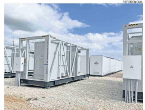
ASÍ LUCEN LOS SISTEMAS DE ALMACENAMIENTO DE BATERÍAS BESS.
