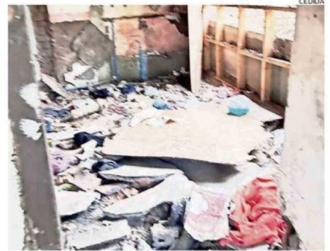
EL INTERIOR DE LA VIVIENDA SE ENCONTRABA DE ESTA FORMA.
