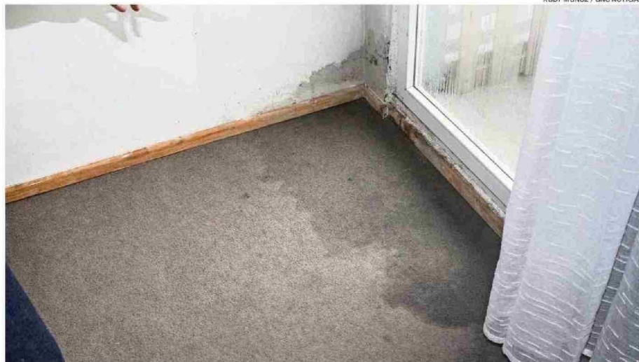
LA HUMEDAD APARECE POR LAS PAREDES Y GENERA HONGOS EN UN 90% DE LOS 220 DEPARTAMENTOS DE ESE CONDOMINIO DE DEPARTAMENTOS.
