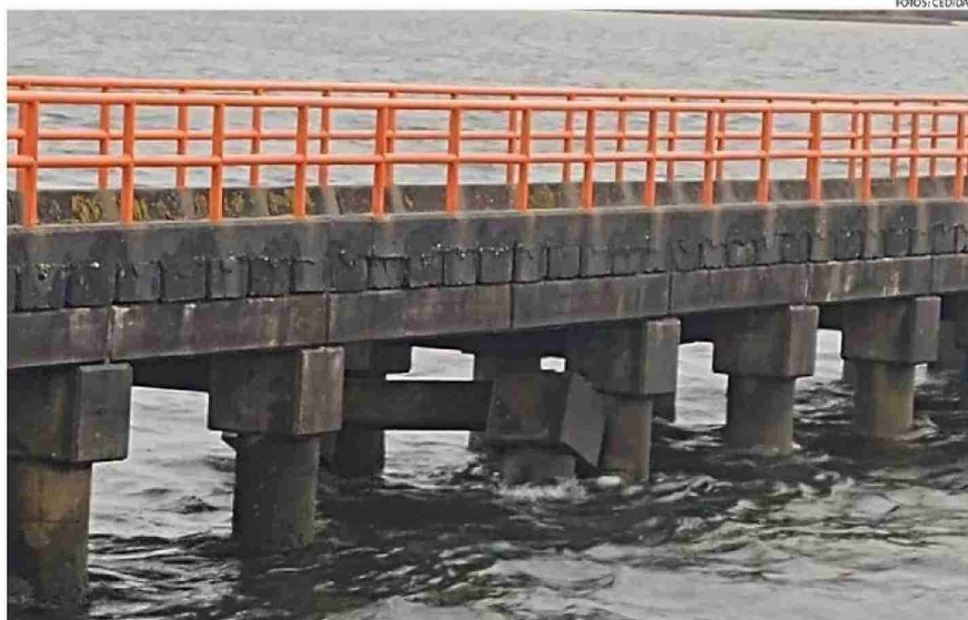
LA MISMA COMUNIDAD INFORMÓ DE UN PROBLEMA PRESENTADO POR UN PILAR DE LA ESTRUCTURA DE CONECTIVIDAD.
