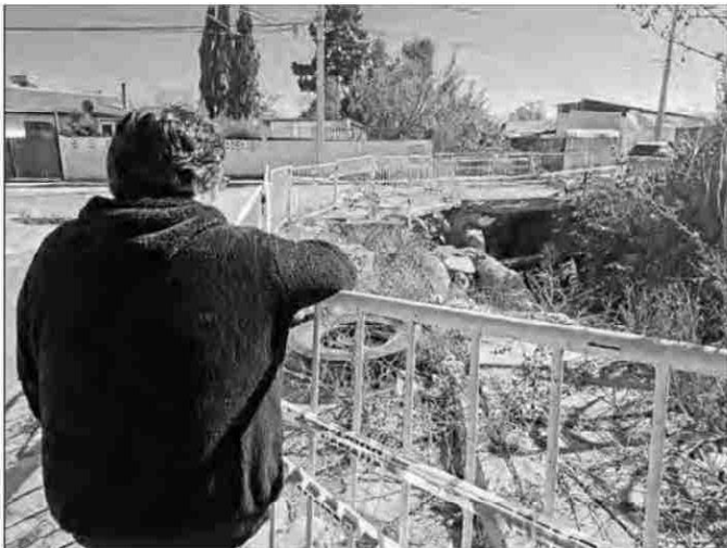
La reposición del puente Los Ciruelos permitirá recuperar la conectividad vehicular en el sector surponiente de Villa Alemana, luego del colapso de la estructura registrado tras los eventos climáticos de 2024.
