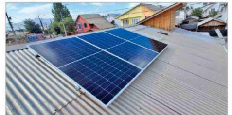
La sede vecinal de Villa Provincial de Rancagua ahora cuenta con paneles fotovoltaicos para su uso diario, lo que le permitirá ahorrar casi la totalidad del consumo eléctrico.
