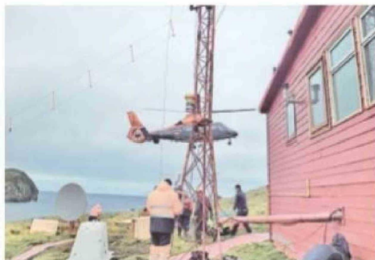
La instalación de instrumentos meteorológicos es un gran desafío por las condiciones extremas del fin del mundo.
