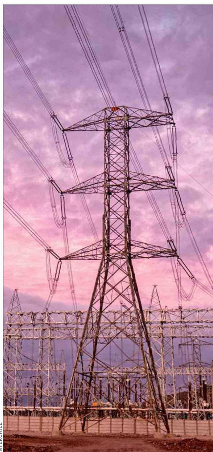
La línea de transmisión Nueva Cardones - Polpaico conecta la Región de Atacama con la Región Metropolitana.
