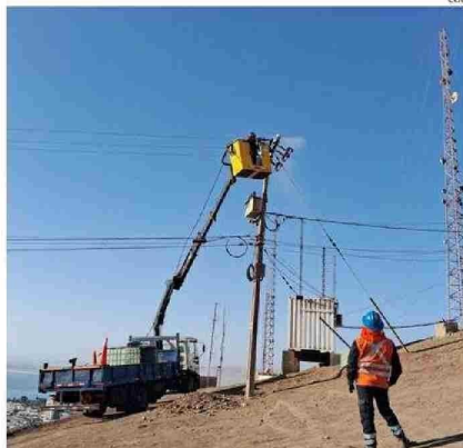
SE LAVÓ LOS AISLADORES CON AGUA DESMINERALIZADA.
