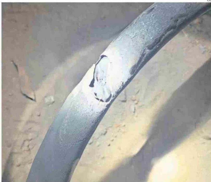
INTENTO DE ROBO DE CABLES EN EL ALIMENTADOR TROCADERO, AFECTÓ A CERCA DE 8 MIL CLIENTES.
