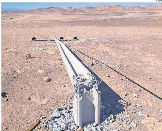
EL ROBO OCURRIÓ LA MADRUGADA DE AYER Y AFECTÓ AL SISTEMA DE ENERGÍA DE PISAGUA.
