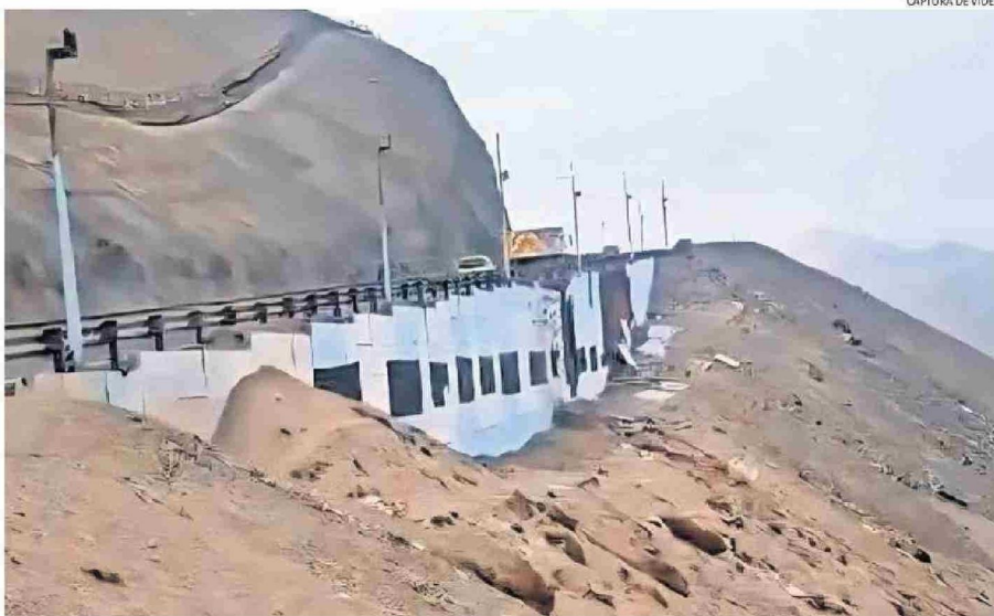
DESDE OBRAS PÚBLICAS SEÑALARON QUE ESTÁN TRABAJANDO EN PROYECTO PARA MEJORAR TRAMO DEL MURO DETERIORADO.
