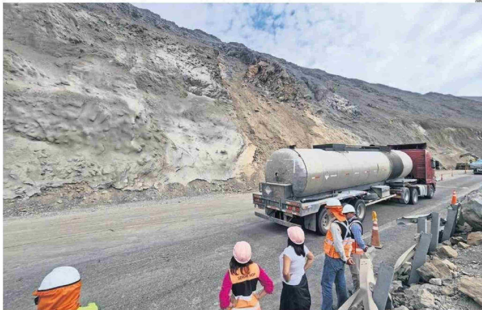
AYER VOLVIÓ A HABER UN DESPRENDIMIENTO DE MATERIAL, EL CUAL TUVO CORTADO EL TRÁNSITO POR CASI 45 MINUTOS.
