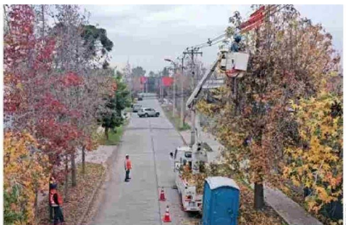
El tendido eléctrico en Chile es mayoritariamente aéreo.
