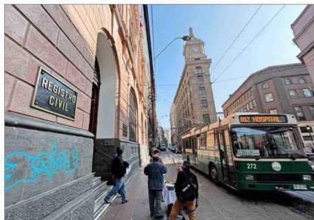
VANDALISMO. — Ayer grafiteros ensuciaron con rayados el recién restaurado frontis del Registro Civil, que recuperó el color rosado de su piedra.
