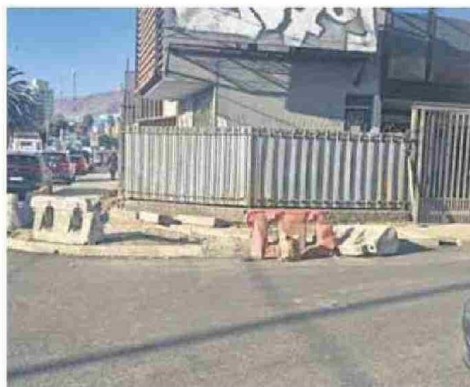
VEREDAS EN MAL ESTADO COMPLICAN A TRANSEÚNTES.
