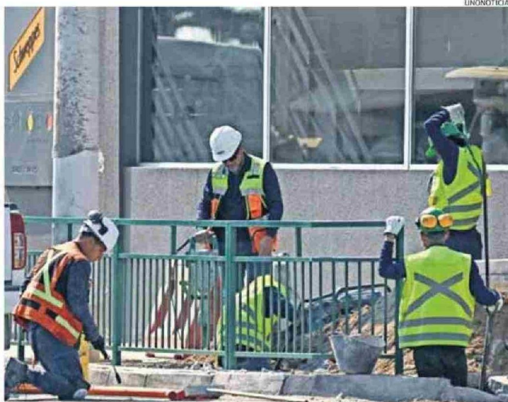
DE ACUERDO CON SERVIU PARTE IMPORTANTE DE LAS OBRAS PENDIENTES SE CONCENTRAN EN ACERAS LATERALES.
