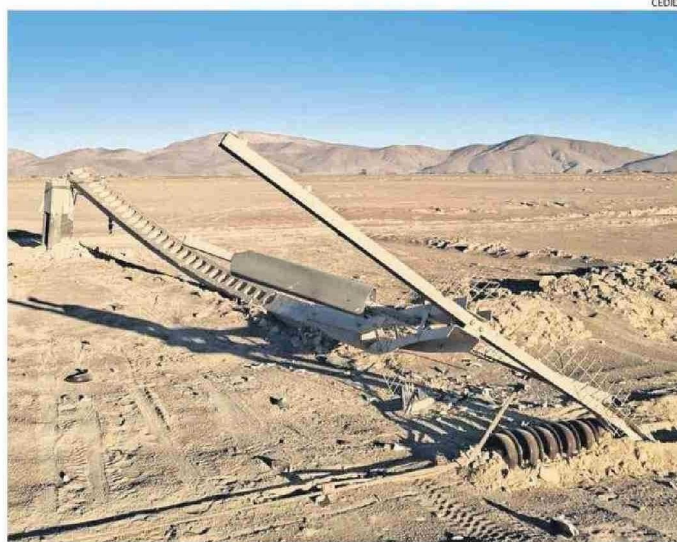
ASÍ FUERON LOS DAÑOS PROVOCADOS PARA ROBAR LOS CABLES DEL TENDIDO ELÉCTRICO.
