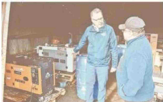
El generador que abastece de electricidad a la Escuela Puerto Toro ya se encuentra en plena operación.
