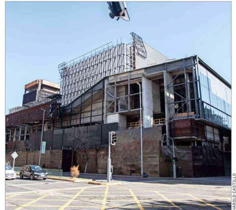
Seguirá esperando: desde 2018 que están paralizadas las obras. El proyecto sumaría 16 mil m 2 a los 22 mil m 2 existentes, con una sala de 2.500 butacas.
