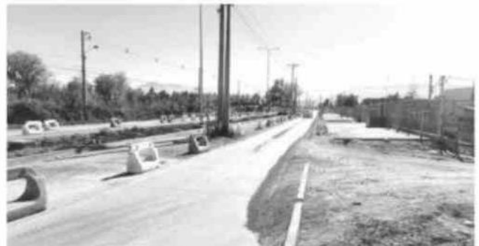
→ Estado de la Avenida Sanchina en Machalí, al exterior de la instalación de faena de Tapusa.
