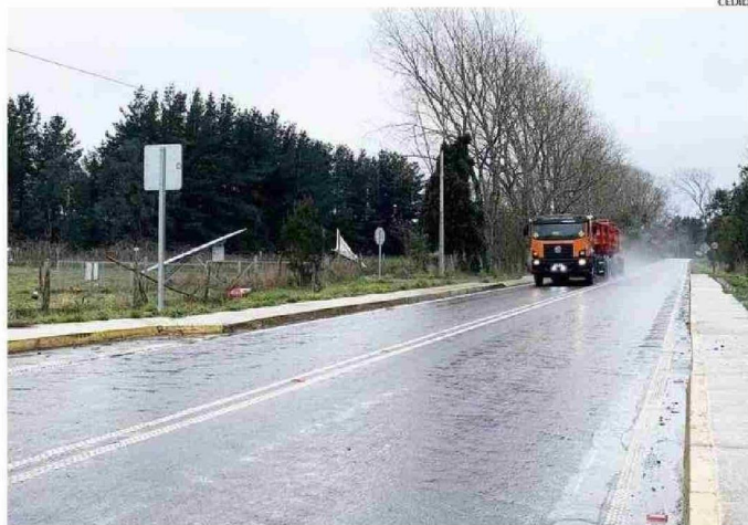
LA RUTA U-55, QUE UNE A OSORNO CON OCTAY, PRESENTA NUMEROSAS DEFICIENCIAS QUE LA VUELVEN RIESGOSA.
