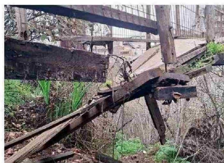
LA ESTRUCTURA ES UN PELIGRO PARA LOS TRANSEÚNTES.
