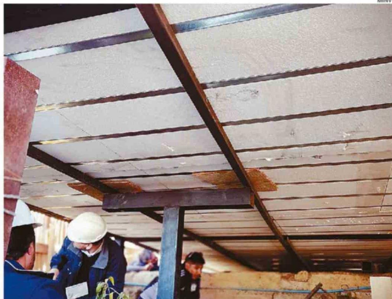
PODUJE INSTRUYÓ ELABORACIÓN DE NUEVOS INFORMES TÉCNICOS TRAS DETECTAR “GRAVES FALLAS”.
