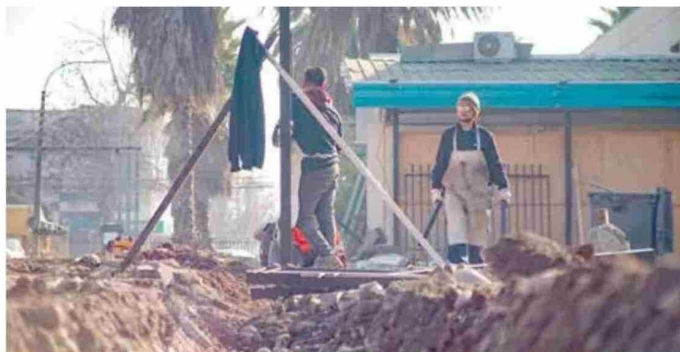
En el lugar se trabaja a toda máquina en despejar el terreno.
