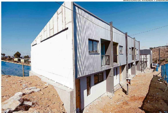
CONSTRUCTORA UTILIZABA PANELES DISEÑADOS PARA VIVIENDAS DE UN PISO EN CASAS DE DOS NIVELES.
