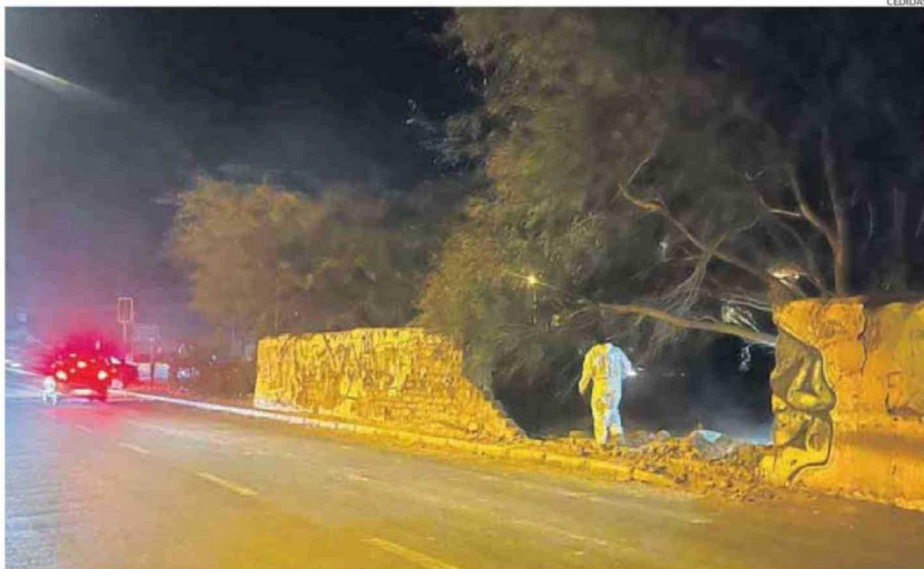
UN MURO SE DESPOMÓ CERCA DEL PARQUE EL LOA Y FUE UNO DE LOS POCOS DAÑOS EN INFRAESTRUCTURA QUE SE REGISTRÓ TRAS EL SISMO.
