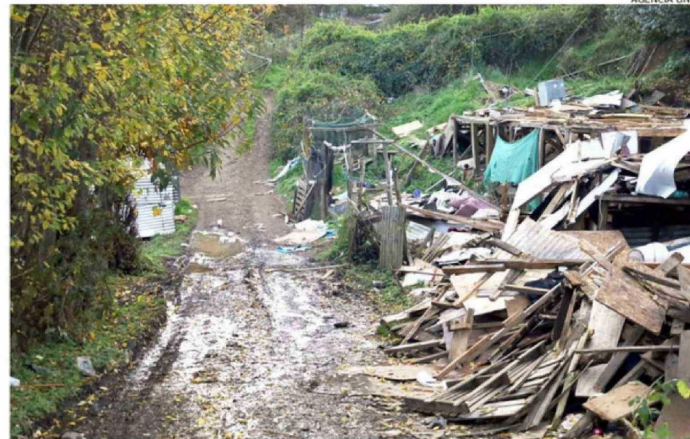
LA LIMPIEZA DEL TERRENO CONTEMPLA EL RETIRO DE TONELADAS DE BASURA ACUMULADAS POR AÑOS.
