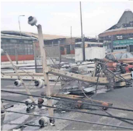
EL IMPACTO DAÑÓ AL TRANSFORMADOR Y OCHO POSTES.
