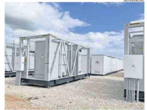
ASÍ LUCEN LOS SISTEMAS DE ALMACENAMIENTO DE BATERÍAS BESS.
