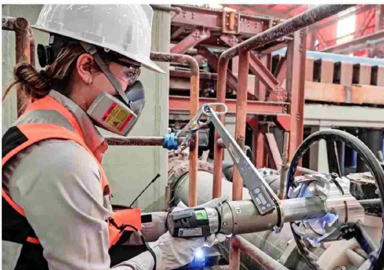
La División Gabriela Mistral de Codelco instaló un actuador portátil mecánico, que reemplaza tareas que demandaban un alto esfuerzo.
