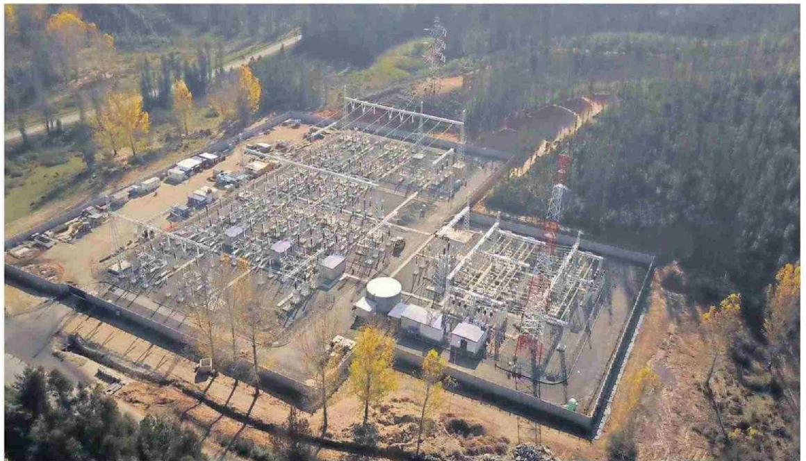
El sistema eléctrico considera la conexión a cinco subestaciones existentes, una en Hualqui.
