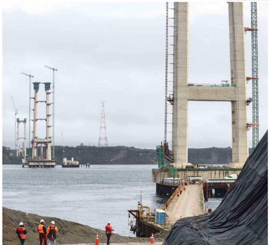
LA OBRA CONTEMPLA LA CONSTRUCCIÓN DE UNA PASARELA A 200 METROS SOBRE EL MAR PARA INSTALAR EL CABLEADO.
