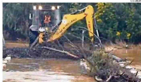
MOP SE ENCUENTRA TRABAJANDO PARA RECUPERAR CONECTIVIDAD.
