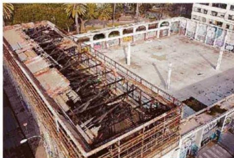
AYER HUBO UN INCENDIO EN EL SITIO DONDE ESTABA EL UNIMARC.
