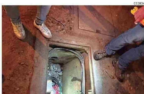
EN EL LUGAR SE HALLÓ EVIDENCIA DEL INTENTO DE ROBO DE CABLES.
