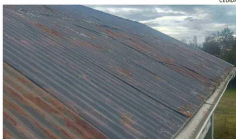
LA ESCUELA PRESENTA PROBLEMAS EN EL TECHO.
