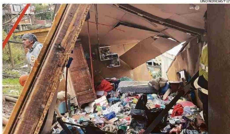
POR EL DERRUMBE MUNICIPIO DIJO QUE ESTÁN EN COORDINACIÓN CON DELEGACIÓN PARA SOLUCIÓN.
