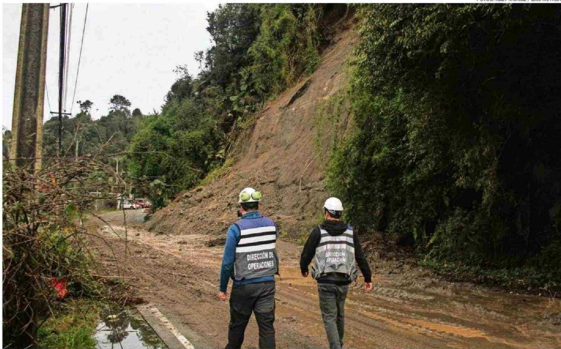
LOS DERRUMBES DE JUNIO PROVOCARON CONSTANTES CORTES DE LA RUTA AL TRÁNSITO VEHICULAR.
