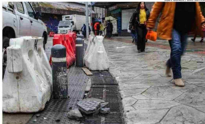
ALGUNAS DE LAS TERMINACIONES DE CALLE VARAS NO SATISFACEN A VECINOS DE ESA CÉNTRICA ARTERIA.
