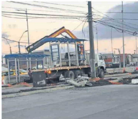
Empresa retiró paraderos de buses instalados en el Eje Colón.
