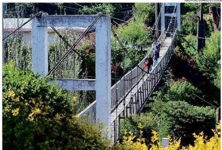
EQUIPO TÉCNICO DEBERÁN LEVANTAR UN PROYECTO PARA EJECUTAR LA REPARACIÓN.
