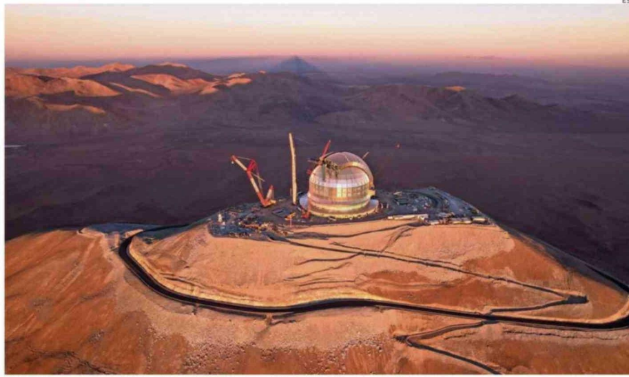
Varias grúas rodean la infraestructura científica que se construye en el Desierto de Atacama.
