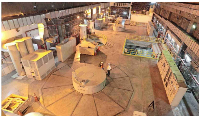
Sala de máquinas de Central Las Lajas.
