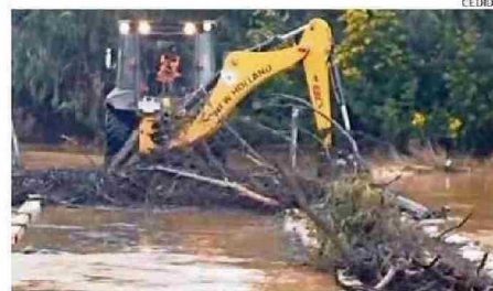
MOP SE ENCUENTRA TRABAJANDO PARA RECUPERAR CONECTIVIDAD.
