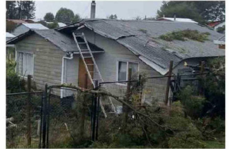
HUBO VOLADURAS DE TECHOS EN DISTINTAS COMUNAS.
